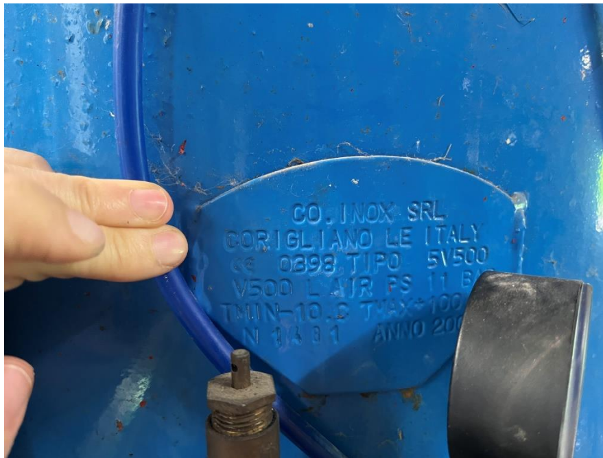
Figura 4: matricola vecchio serbatoio
